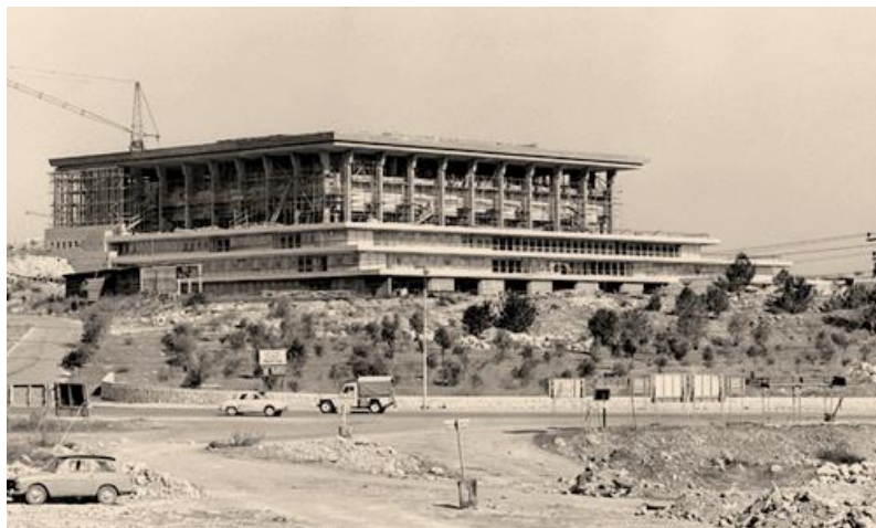
סולל בונה הייתה הקבלן הראשי בבניית משכן הכנסת שנמשכה בין השנים 1960-1966. התמונה מחורף 1963.
